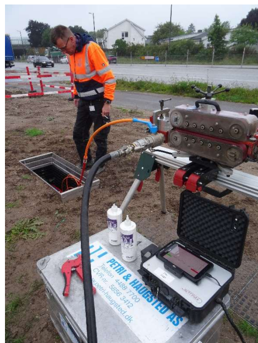
Formand Michael Andersen checker specs på indblæsningen. Data logges på den tilsluttede JetLogger, men ellers kræver Jetting MJet V3 hverken hydraulik eller elforsyning. Den kører udelukkende på tryklufft.
